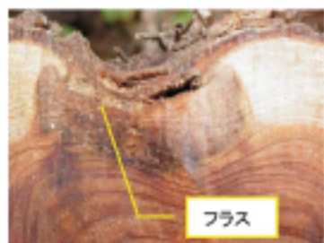
写真3 食害部にのこされたフラス
